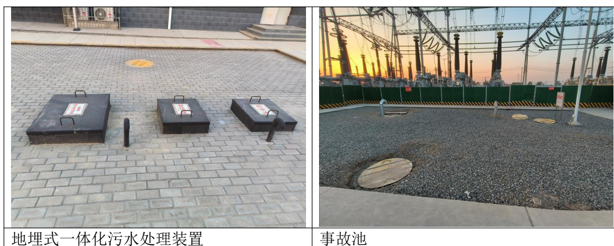
图3.2-5 万泉330kV变电站现有环保措施现状
