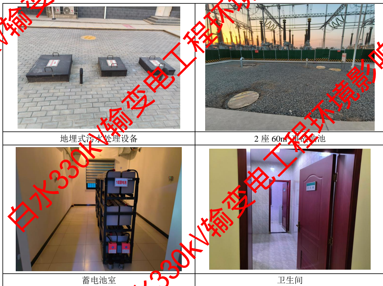
图 3.1-5 万泉 330kV 变电站现有环保设施
